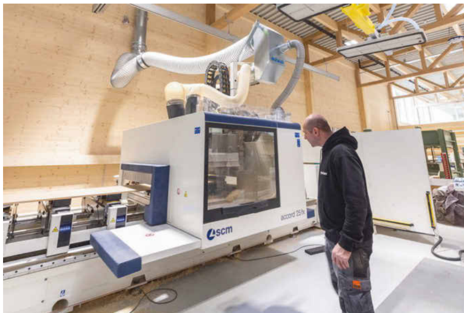
Bei den 28 Bearbeitungsmaschinen achtete Scheuch LIGNO auf eine schlichte und für die Halle optimale Rohrführung.
