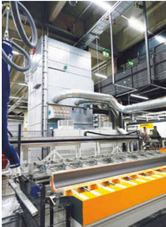
Roma betreibt die Absaugung mit großer Zufriedenheit und plant eine weitere Zusammenarbeit mit Al-Ko
