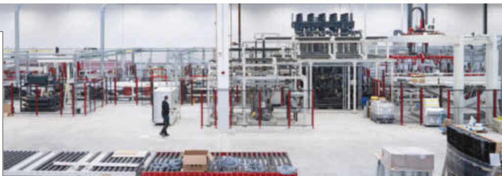
Im vergangenen Jahr wurde in Gütersloh auf über 10 000 m 2 ein neues Plattenwerk installiert. Seit April 2023 läuft die Produktion von Türdecks und Zargenteilen
